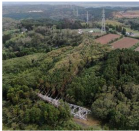
<鉄塔の倒壊（君津市）>
