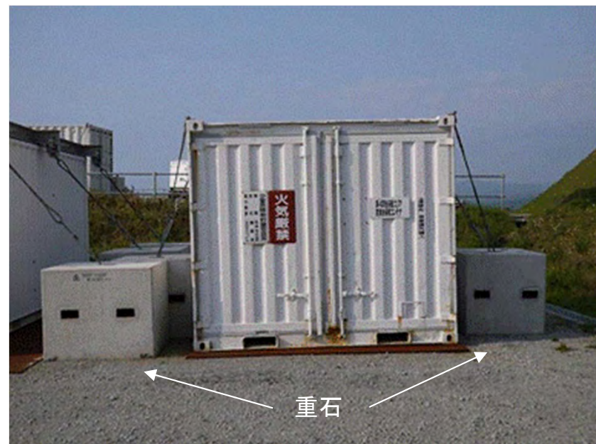
コンテナの飛散防止対策
