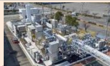
神戸市のポートアイランドに整備された水素発電施設（水素CGS）
