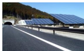
道路における太陽光発電の活用
