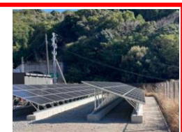
太陽光発電施設
