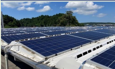
太陽光パネル
