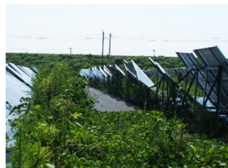
不十分な管理で放置されたパネル
