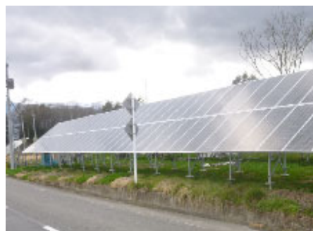
柵塀の設置されない設備
