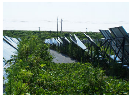
不十分な管理で放置されたパネル
