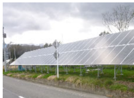
柵塀の設置されない設備
