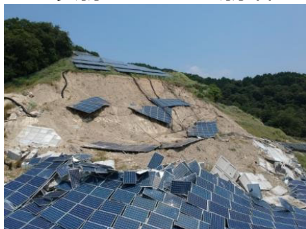
土砂崩れで生じた崩落
