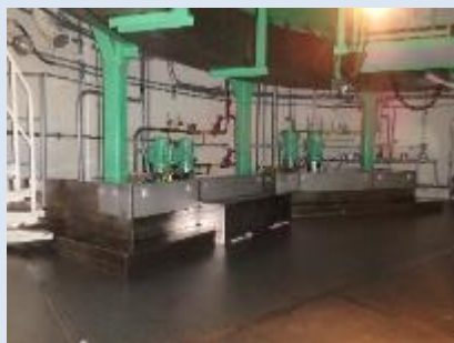
導入された コリウムシールド
