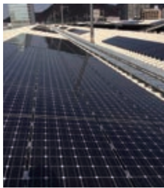
▲東北新幹線ホーム屋根の軽量型太陽光パネル
