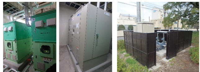
ヒートポンプユニット
