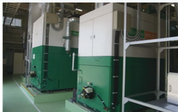
設置された木質バイオマスボイラー
