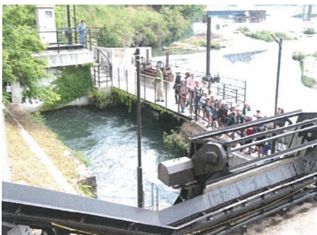
除塵機の実運転を見学する地元小学生
