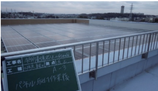
和みの園の屋上に設置された太陽光パネル
