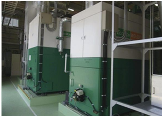
設置された木質バイオマスボイラー
