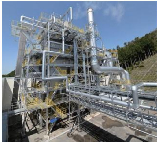
真庭バイオマス発電所のバイオマス発電設備
