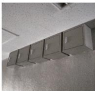
非常用コンセント
