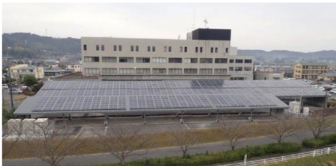
コンパクトグリッド1（行政エリア）太陽光全景
