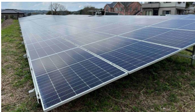
高滝発電所1号機
