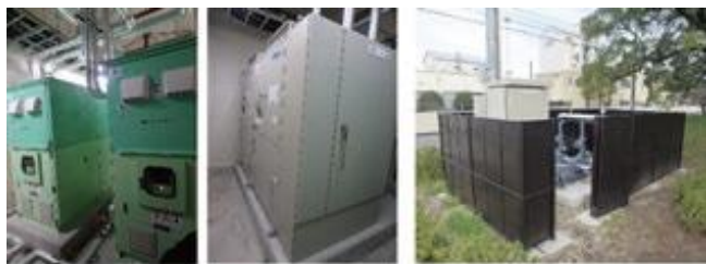
ヒートポンプユニット 工場排湯の送湯施設
