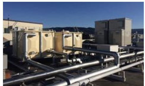
設置された地中熱ヒートポンプシステム
