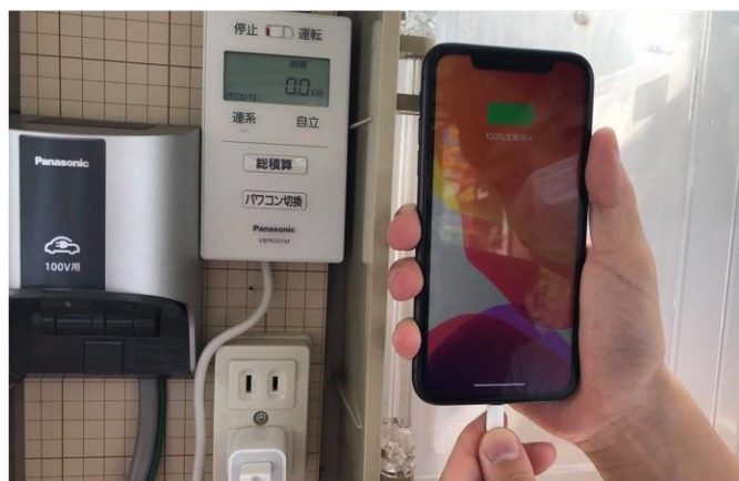
ソーラーチャージャーの非常用電源からの給電
