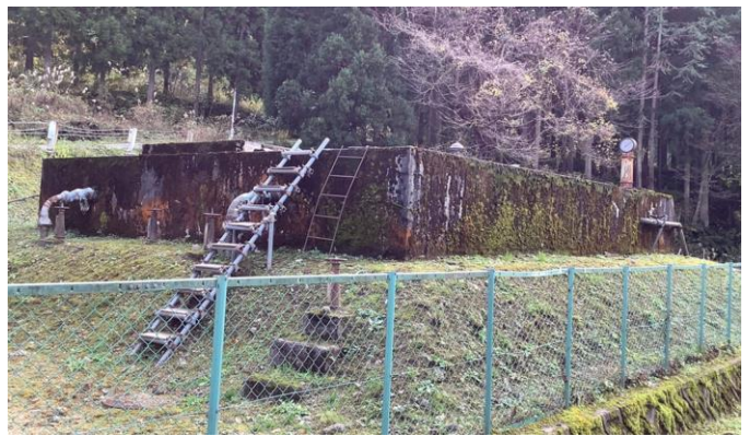
老朽化した簡易水道の設備
