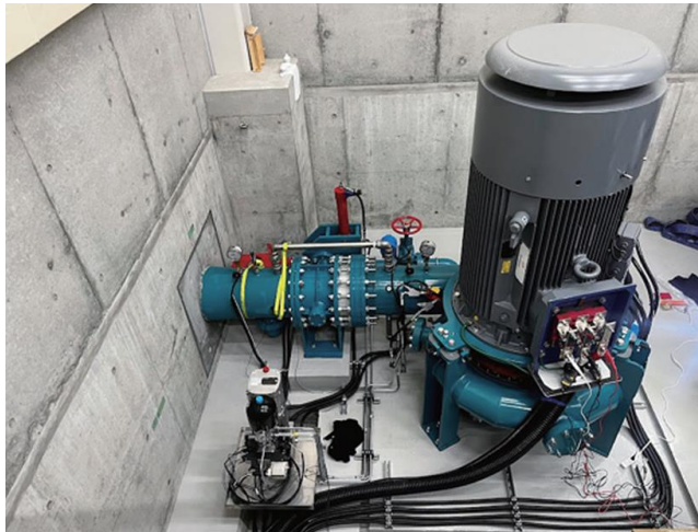
笹川小水力発電所の発電設備
