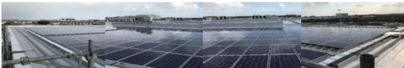
太陽光パネル
