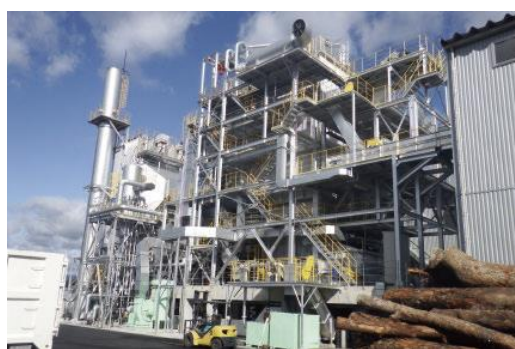
グリーン・エネルギー研究所の木質バイオマス発電所
