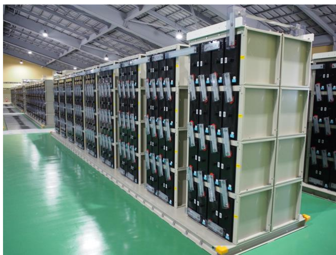
蓄電池システム
