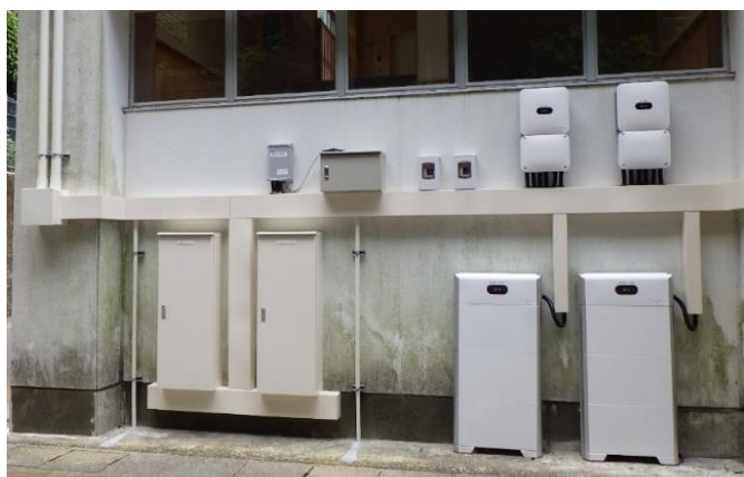
学校屋上への太陽光パネル設置に付随する パワーコンディショナー・蓄電池設置
