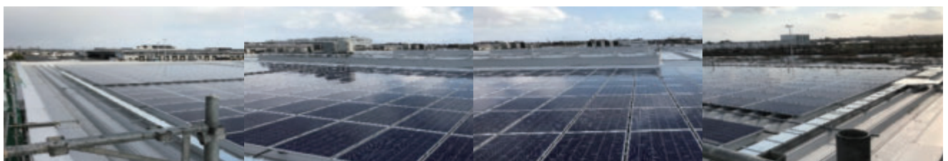
太陽光パネル
