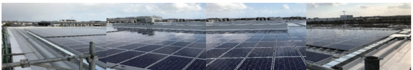
太陽光パネル
