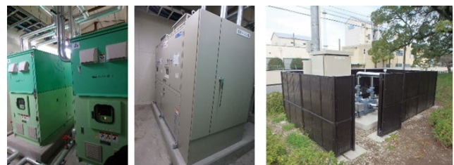
ヒートポンプユニット
