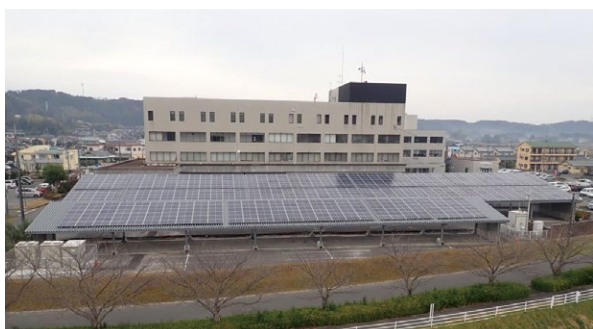
コンパクトグリッド1（行政エリア）太陽光全景
