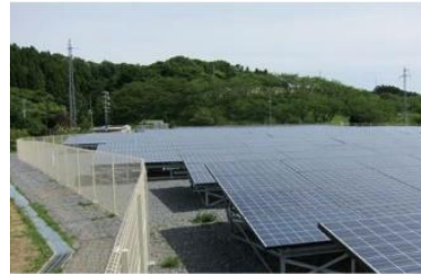
▲ 太陽光発電設備
