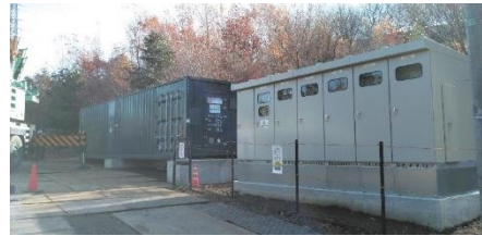
▲ 地域マイクログリッドに設置された大規模蓄電池
