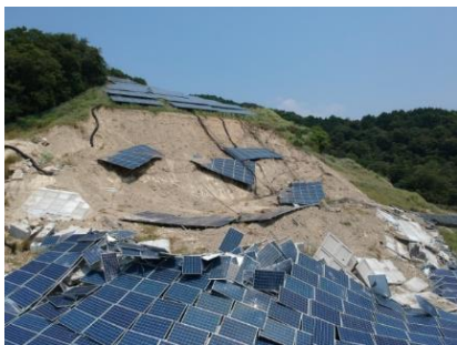
土砂崩れで生じた崩落
