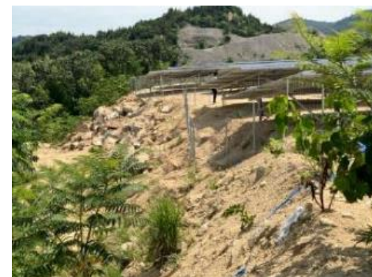
盛土が大きく崩落した太陽光発電設備
