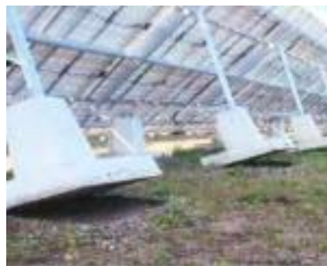
強風で架台が持ち上がり傾き
