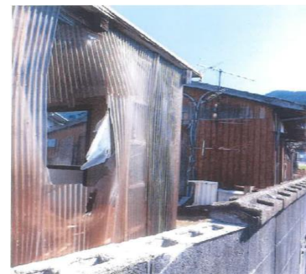
破損した民家
