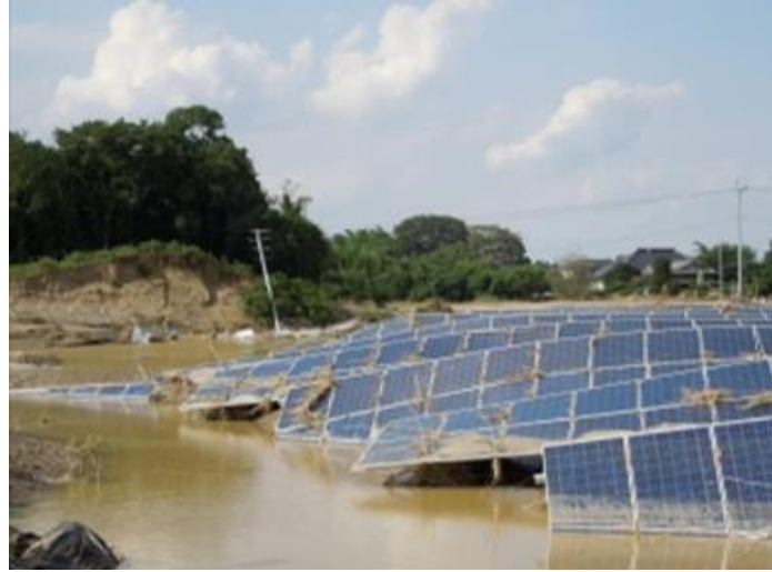
図 4-14 鬼怒川の決壊被害で水没したパネル
