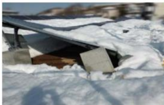
図 4-13 積雪荷重が設計を超えたため、基礎沈降した太陽光パネル
