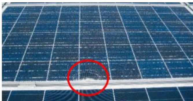
図 4-19 鳥類の落石によるモジュール破損の事例
