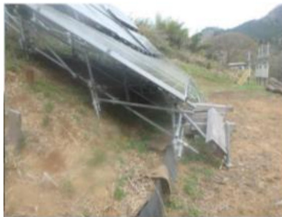
図 4-11 安全性に懸念のある施工
