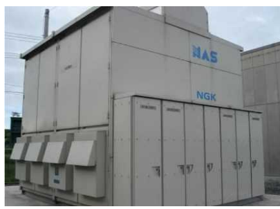
大型蓄電システム施設
