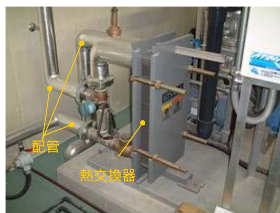
写真 4.2.4 熱交換器周り
