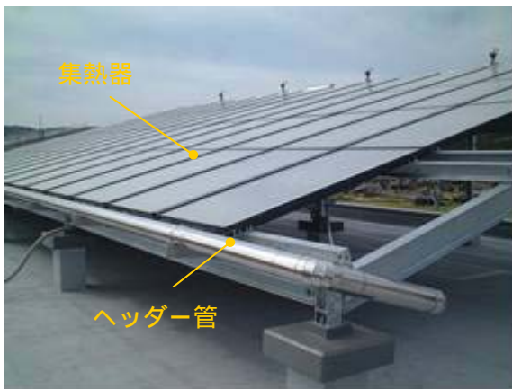
写真 4.2.1 集熱器、配管周り
