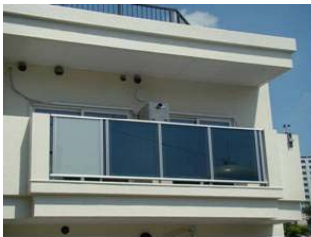
<ベランダ設置型> 資料提供）東京ガス（株）
