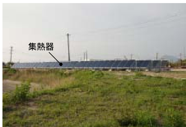
<集熱器設置状況(陸上架台方式)>
