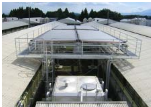
<豚舎間に設置された集熱器と蓄熱槽>
