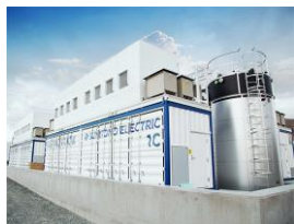
系統安定化のための蓄電池
