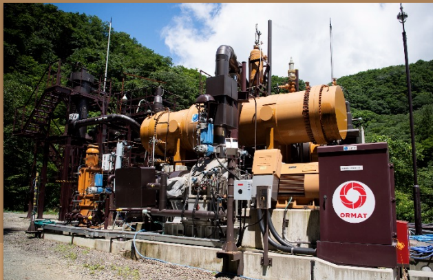
土湯温泉16号源泉バイナリー発電所
