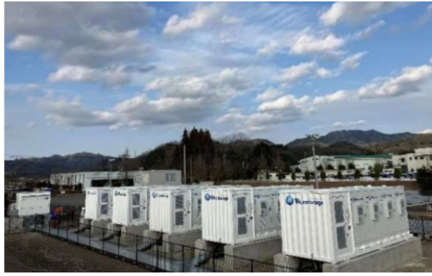
蓄電池設備 全景
