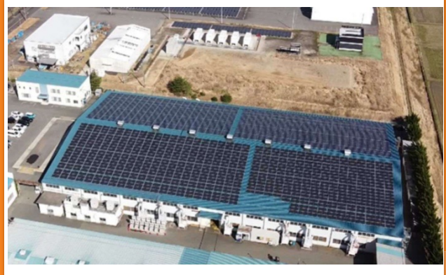
太陽光発電設備 協賛企業設置事例
