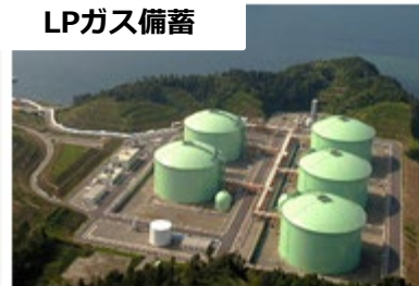
LPガス備蓄
