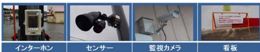
図2機器の設置状況
