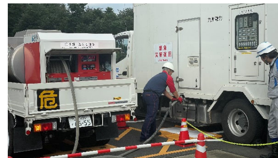
優先供給施設における 高圧発電機車への模擬給油訓練
