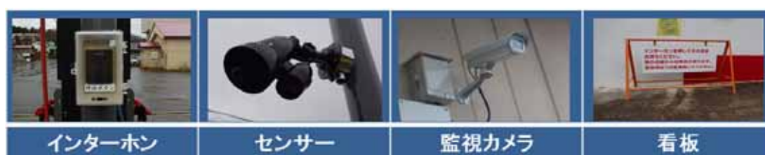
図2機器の設置状況
