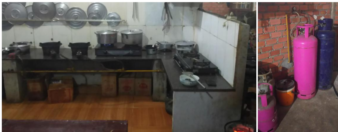
＜LPガスを使用するレストランの厨房＞
