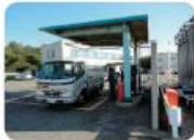
LPガス自動車充填設備
