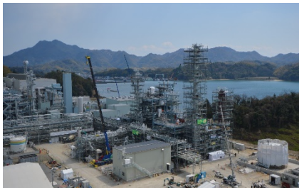
大崎クールジェン IGCC + CO 2 回収プロセス実証
