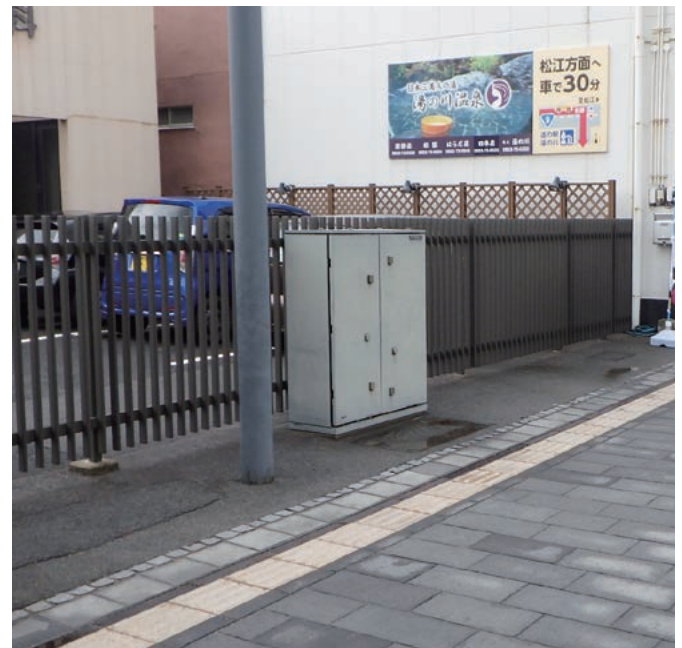
地上機器設置例(官地)
