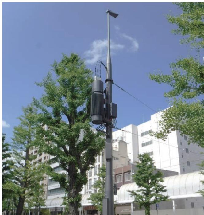
地上機器設置例(柱状型変圧器)
