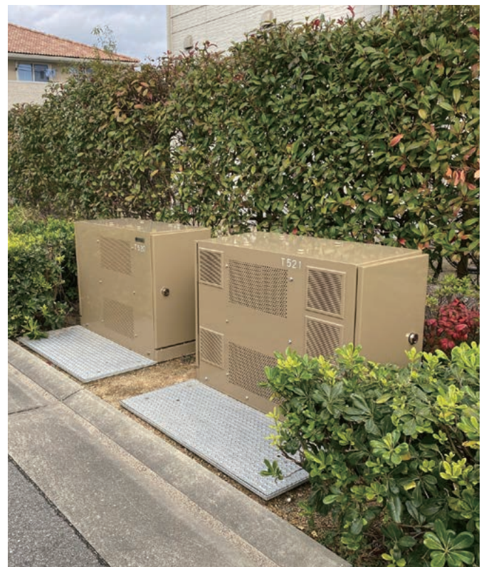
地上機器設置例(植樹帯)
