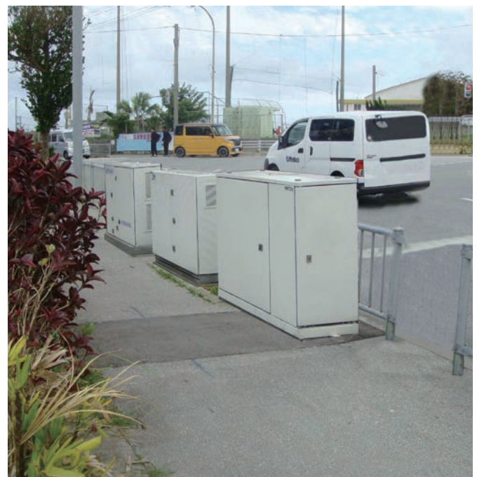
地上機器設置例
