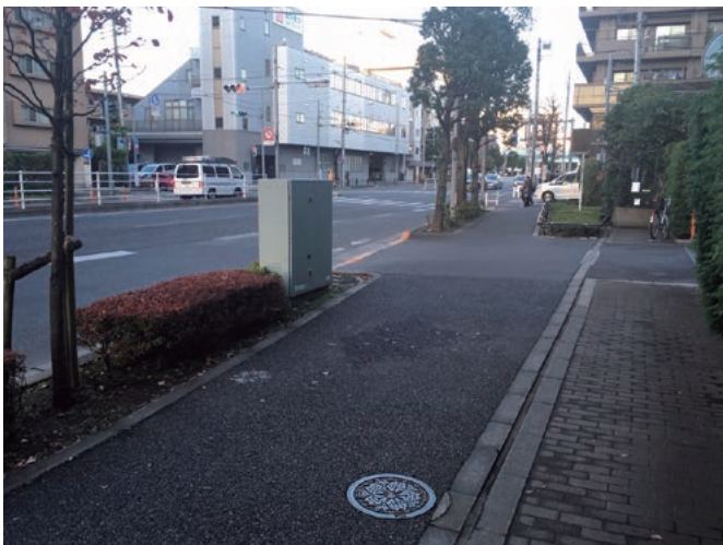
地上機器設置例(植樹帯)
