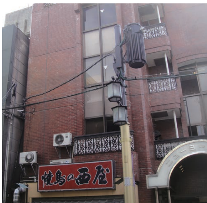
地上機器設置例(柱状型変圧器)
