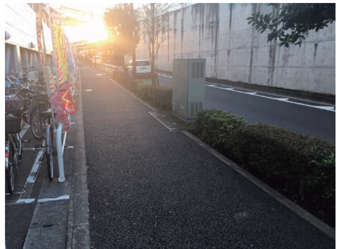
地上機器設置例(植樹帯)
