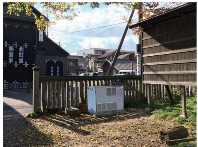
地上機器設置例(神社の境内)
