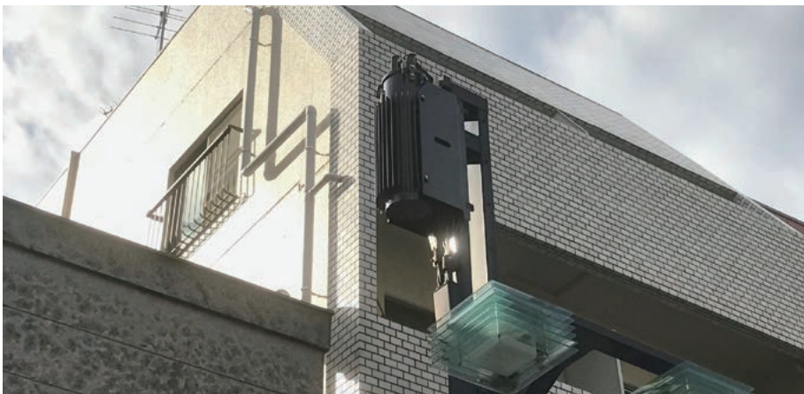
地上機器設置例(柱状型変圧器)
