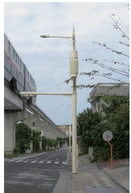
地上機器設置例(柱状型機器)
