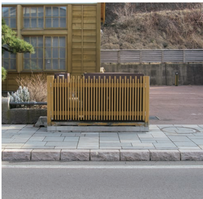
地上機器設置例(景觀配慮)
