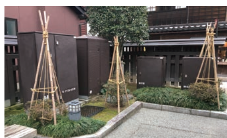
地上機器設置例(公園)
