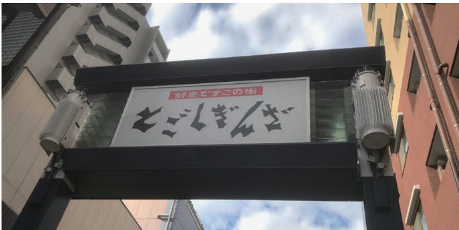
地上機器設置例(柱状型変圧器)
