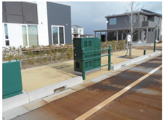
地上機器設置例
