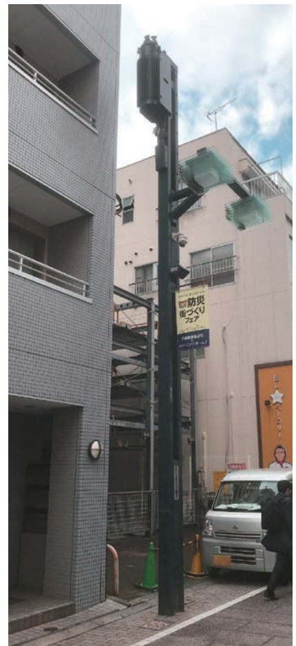
地上機器設置例(柱状型変圧器)
