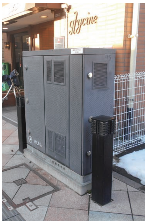
地上機器設置例
