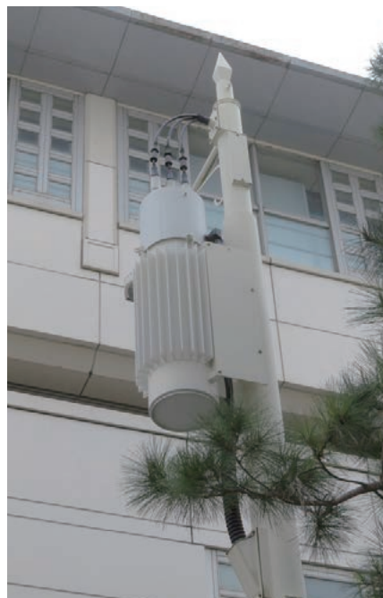
地上機器設置例(柱状型機器)
