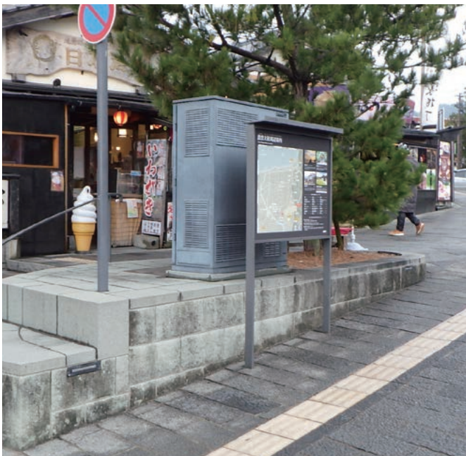
地上機器設置例(官地)
