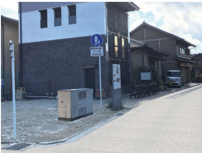
地上機器設置例(公園予定地)
