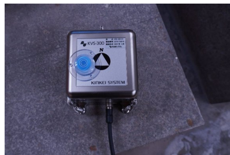
図 12. 設置された地震計
