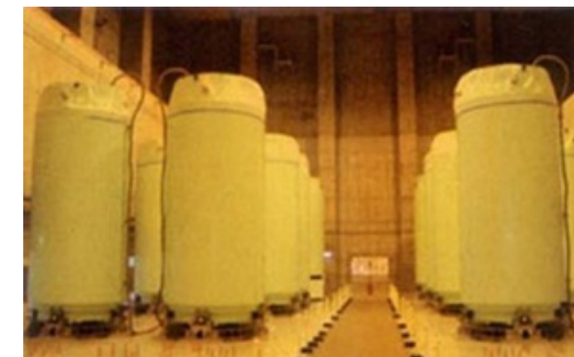
日本原子力発電 東海第二発電所での乾式貯蔵
