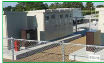
通常とは別の送電線から受電する設備を設置し、多重化
