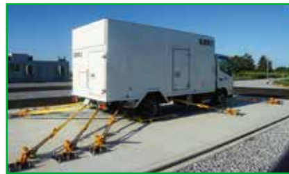
外部電源喪失時に使う電源車を設置
