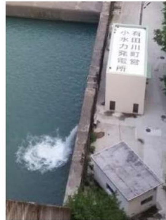
小水力発電所（上）と維持流量放流設備（下）
