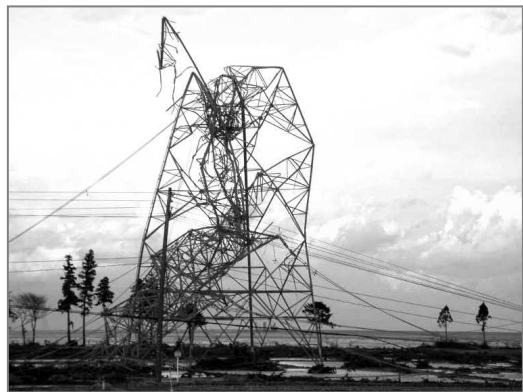
〔折損した鉄塔〕
