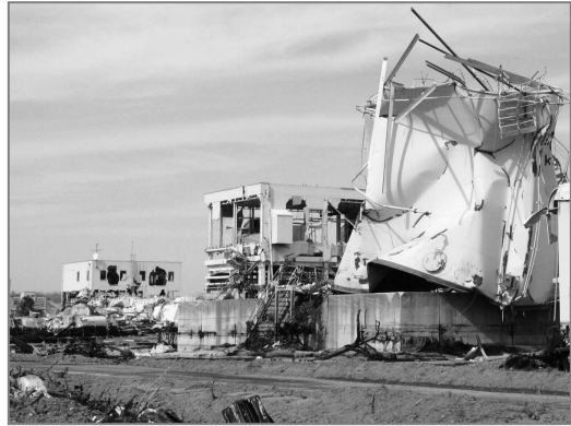
〔原町火力発電所〕
