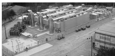
大容量電源装置 （女川原子力発電所）
