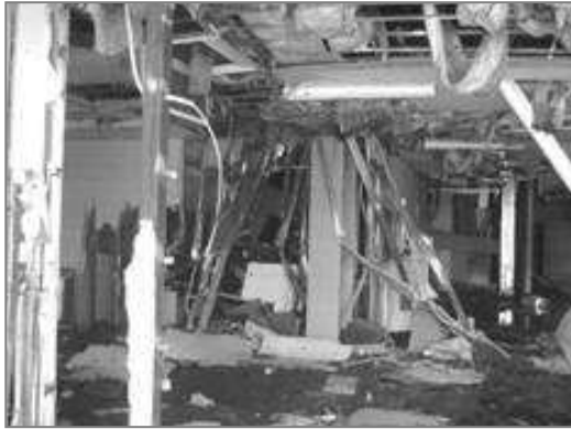
〔仙台火力発電所〕
