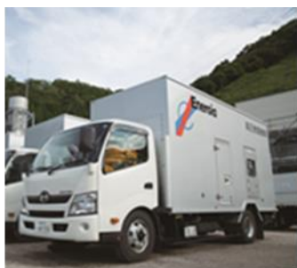
可搬型設備（高圧発電機車）
