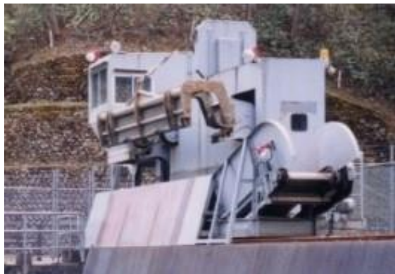
取水口除塵機 全景
