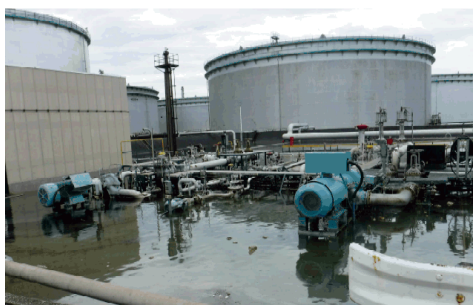
冠水した製油所敷地 (2019年10月台風)
