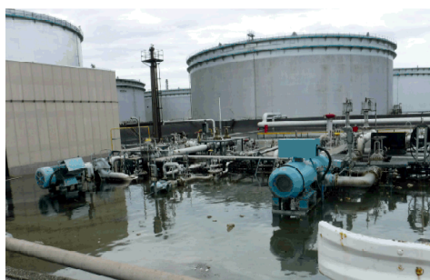
冠水した製油所敷地 (2019年10月台風)
