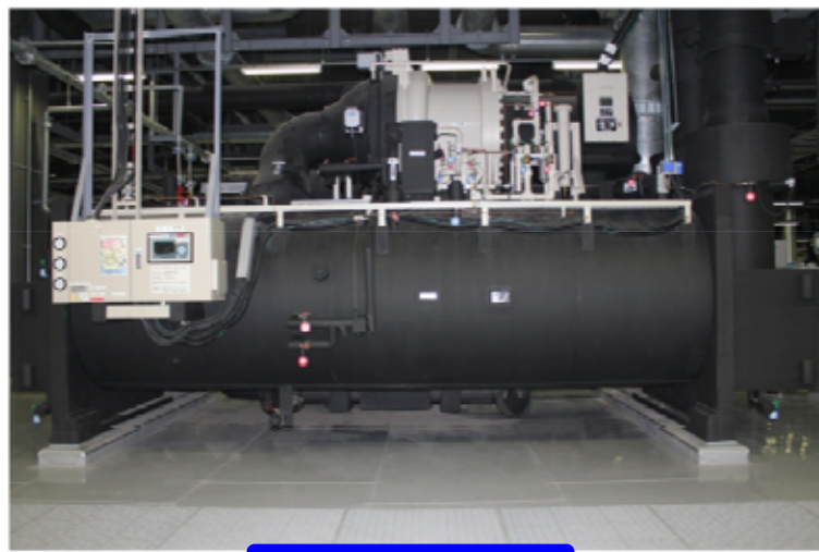
高効率ターボ冷凍機
