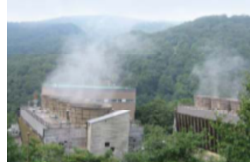
【地熱発電設備】
