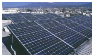
【太陽光発電設備】
