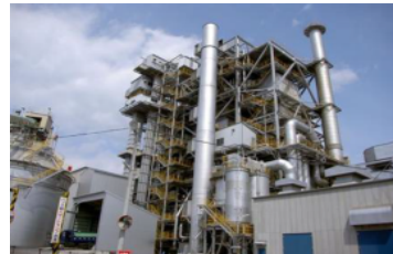
【バイオマス発電設備】
