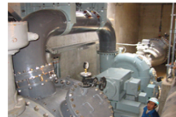
【水力発電設備】
