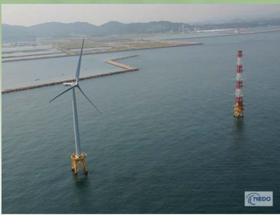
北九州市沖に設置した洋上風力発電設備
