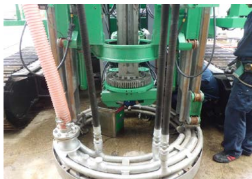
図 2.1.9-13 噴射・吸引設備のうち塩水噴射・スラリー吸引装置（平成 26 年度改良後）
