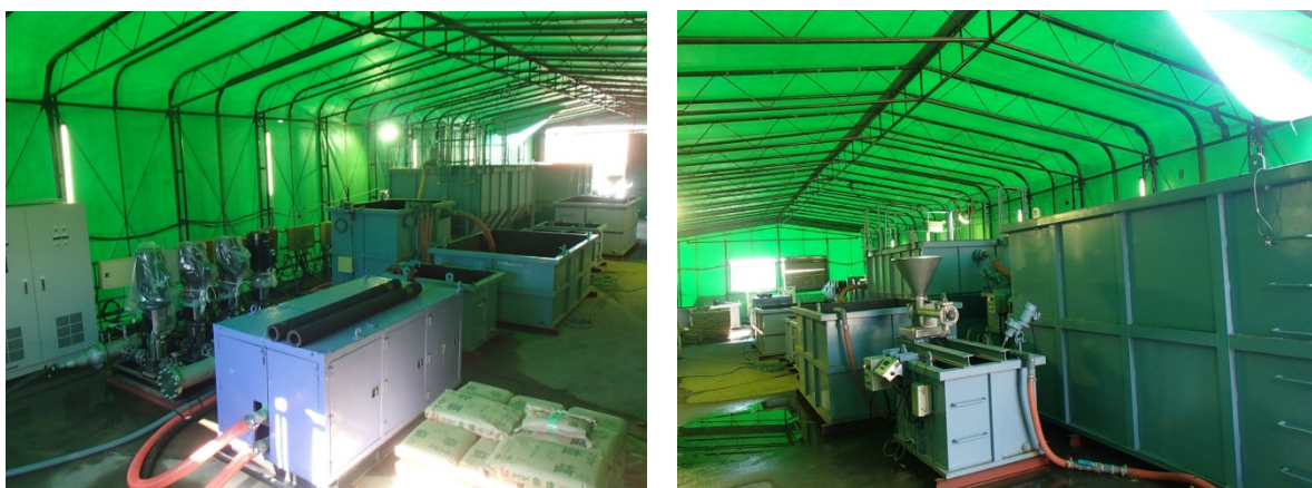
図 2.1.3-7 塩水リユース設備の製作状況
