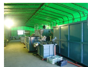
(c) 塩水リユース設備
