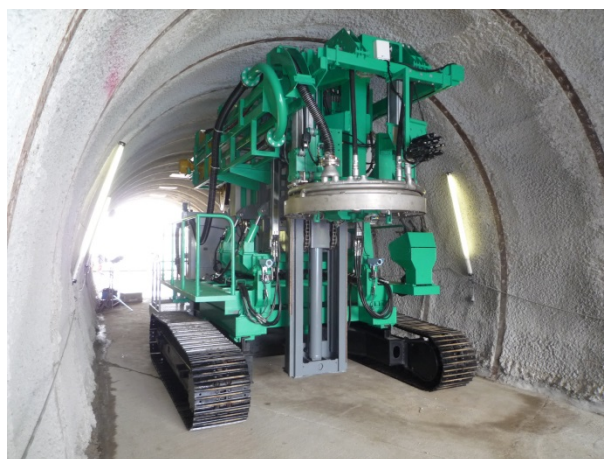
図 2.1.9-12 噴射・吸引設備の改良後全景（平成 26 年度）
